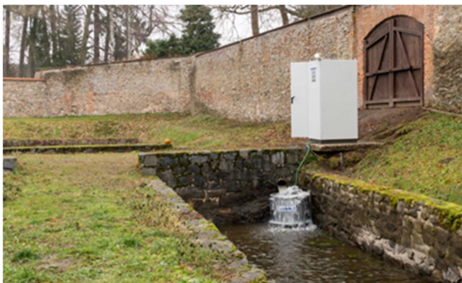
Obrázek: Příklad umístění vodní mikroturbíny na výpusti. Zdroj: ŽĎAS, a.s.
